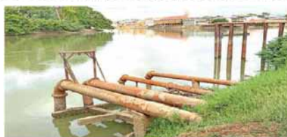
Esta infraestructura hidráulica de más de 20 años es la que renovará Aqualia.
